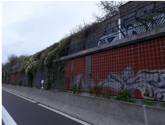
Abbildung 118: Lärmschutzwand an der B 45 im Bereich Weiskirchen, © Regierungspräsidium Darmstadt
